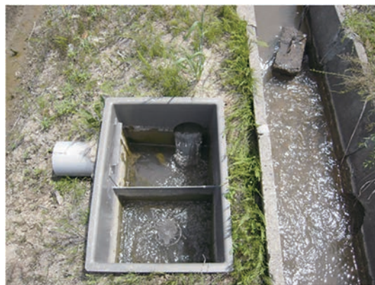
写真3. 暗きょ清掃用施設「集中管理孔」
