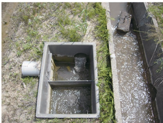
写真5. 暗きょ清掃用施設「集中管理孔」
